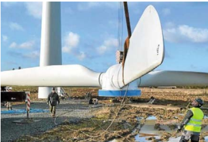
L'entreprise nordiste DDIS a breveté une technologie d'installation qui ne nécessite que cinq personnes.
